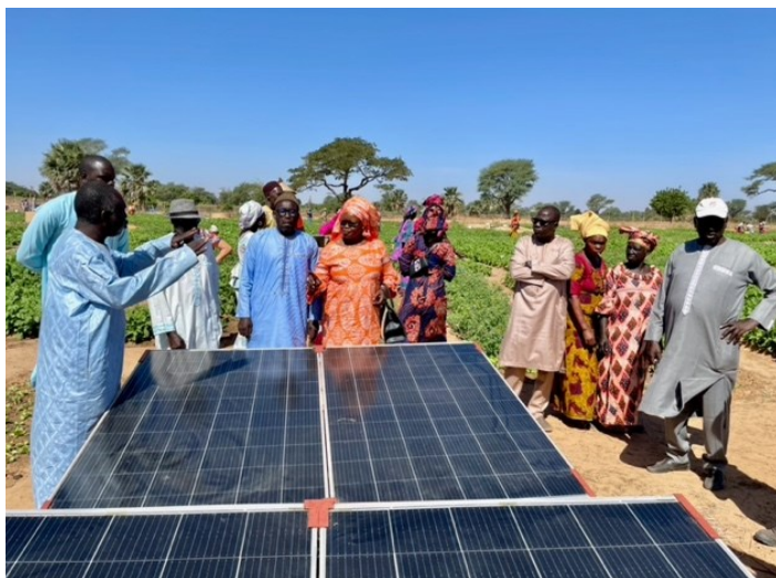
Nouvelles installations de panneaux solaires pour remplir les bassins de rétention
